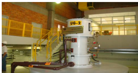
Unidade Geradora Hidráulica
