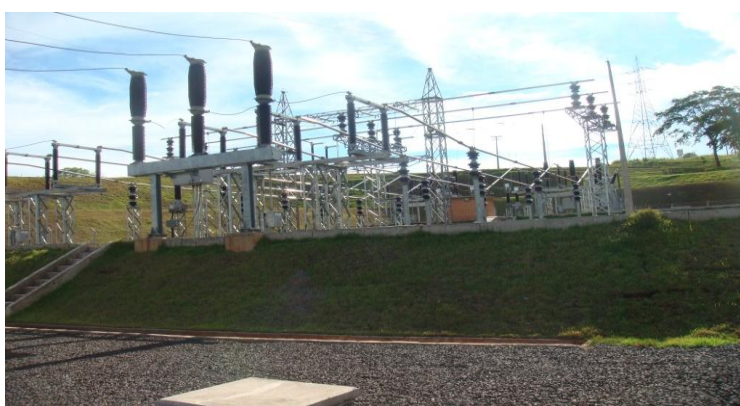
Vista Panorâmica da Subestação de Elevação
